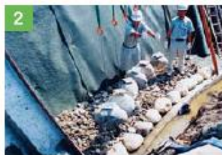
2 アンカー材の吊上げ部を利用して、クレーン等で仮置きします。
