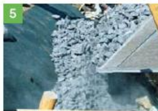
5 割栗石を投入して、均一になります。(2～5を繰り返す) 割栗石は石の間隙から吸い出されないよう、粒径φ50～150mmを厳守ください。
