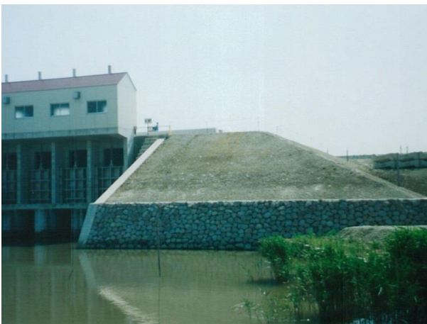
農水省 有明海岸保全事業所 黒崎排水樋門
