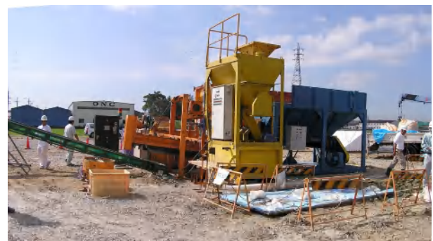
写真-1 粒状固化装置（セパレート型）全景
