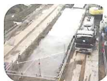
C 泥土貯留ピット
