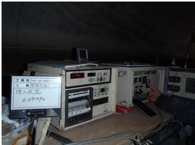
注入状況(流量計)
