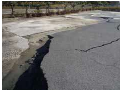
写真-2 震災により JAEA 敷地内でも液状化
