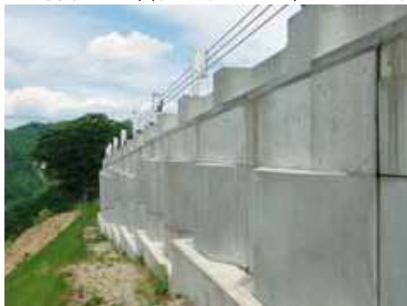
写真-5 壁面状況（烏帽子の2, H=2.0-4.0m）
