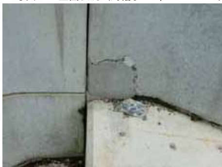
写真-6 基礎との境界部に欠け（茂庭沢）
