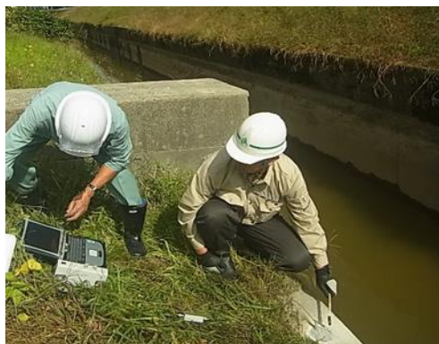
写真-3 用水路擁壁亀裂調査
