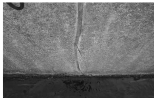
写真-1 シーリング材近接部におけるひび割れと浮き
