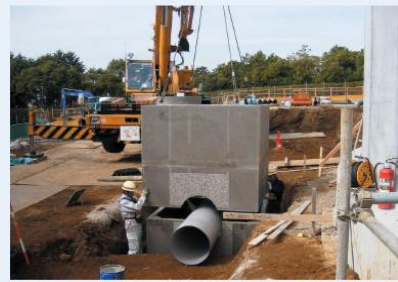
分割タイプ(現場配管)電磁流量計室
