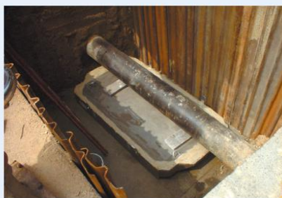
分割タイプ(既設管割り込み)超音波流量計室 1
