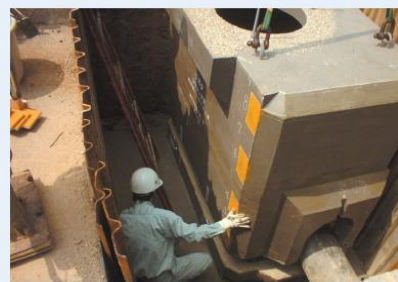
分割タイプ(既設管割り込み)超音波流量計室 2
