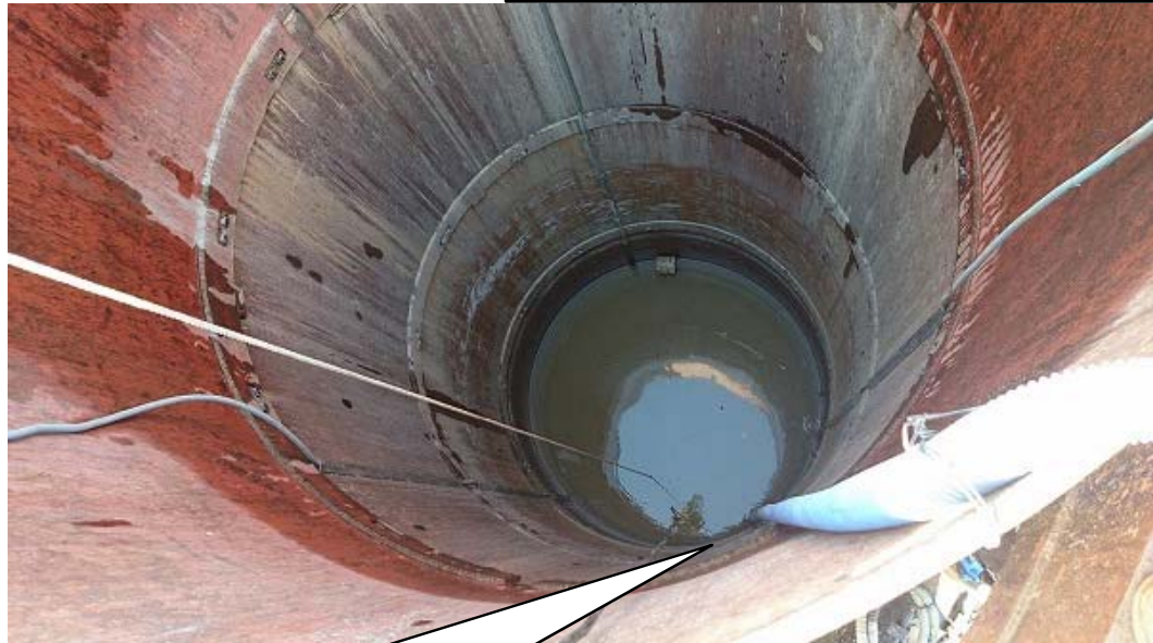
オールケーシング立坑の汚濁水状
