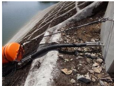
流木防止設備の係留部使用
