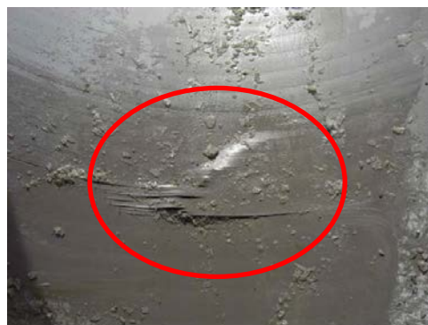
図 4.2 異物による管内面の周方向亀裂
