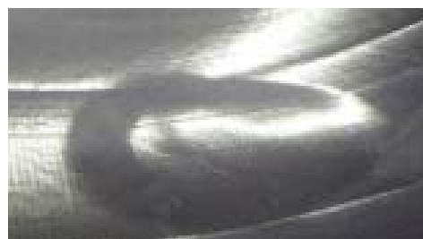
図 5.9 管内面状況 (強度アップ品)
