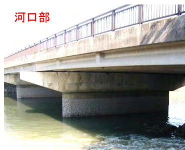
河口部 既設床版下面・地覆の塩害対策
