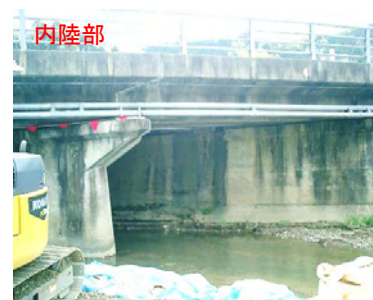
内陸部 既設床版下面・橋台の中性化対策
