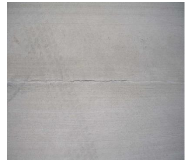
打継部詳細写真
