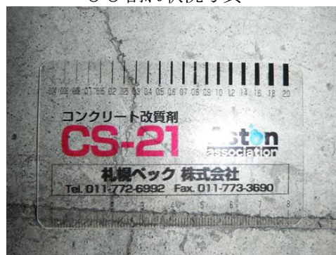
ひび割れ状況写真
