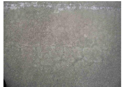
ひび割れ詳細写真
