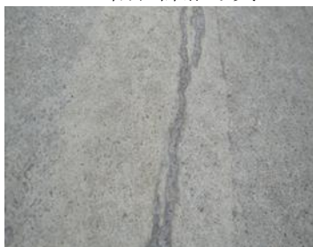
ひび割れ詳細写真
