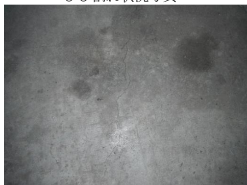
ひび割れ状況写真
