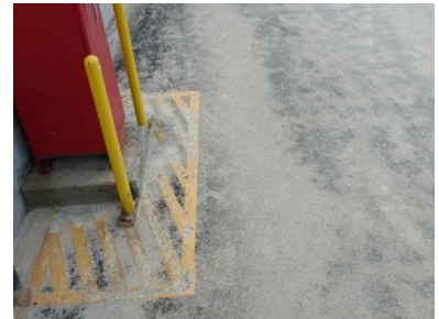
ひび割れの状況写真
