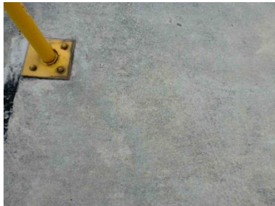
ひび割れの状況写真
