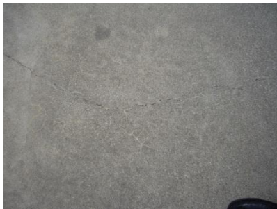
ひび割れ詳細写真
