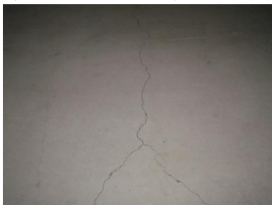
自閉していないひび割れの写真
