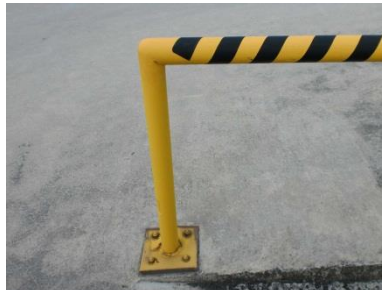
ひび割れの状況写真
