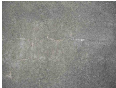
ひび割れ詳細写真
