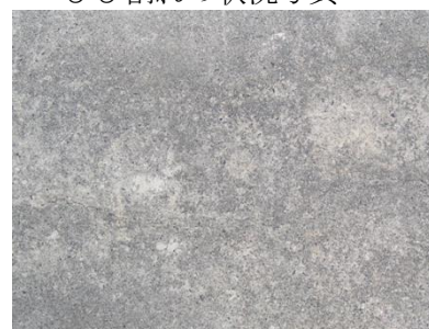
ひび割れの状況写真
